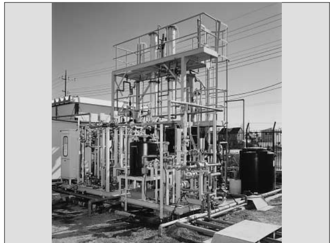
図 18 実験膜汚過装置(膜材質 PVDF, 処理水量 35 m³/日)
