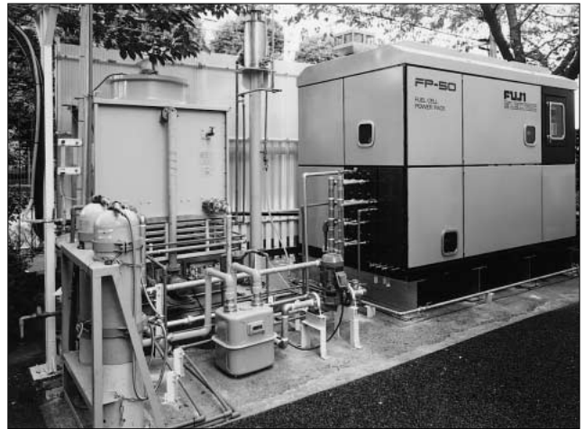
図10 バイオガス燃料電池発電システム
