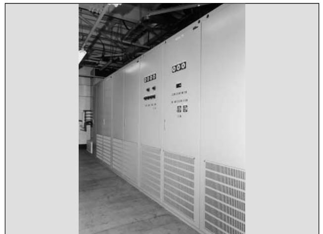
図 30 周波数変換装置
