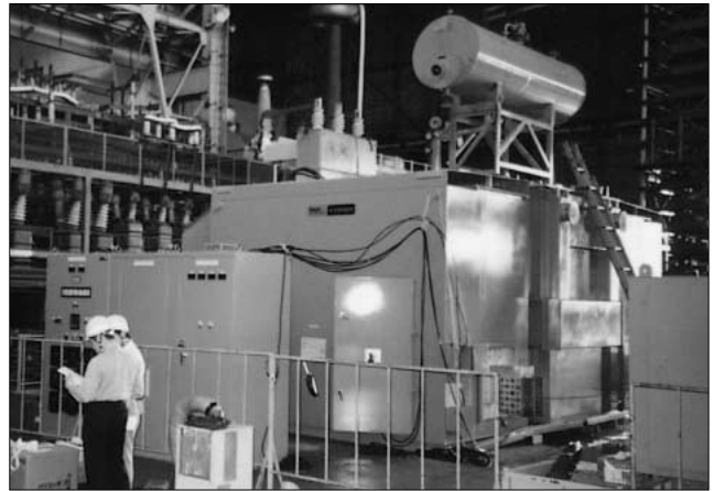
図1 ダウケミカル向けクロールアルカリ電解用サイリスタ整流設備
