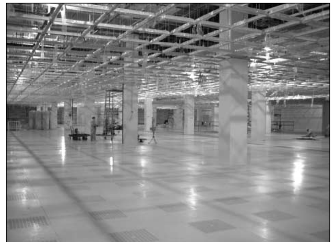
図 23 台湾某社向けクリーンルーム
