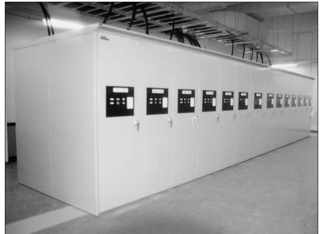
図 28 御崎車庫直流高速度真空遮断器
