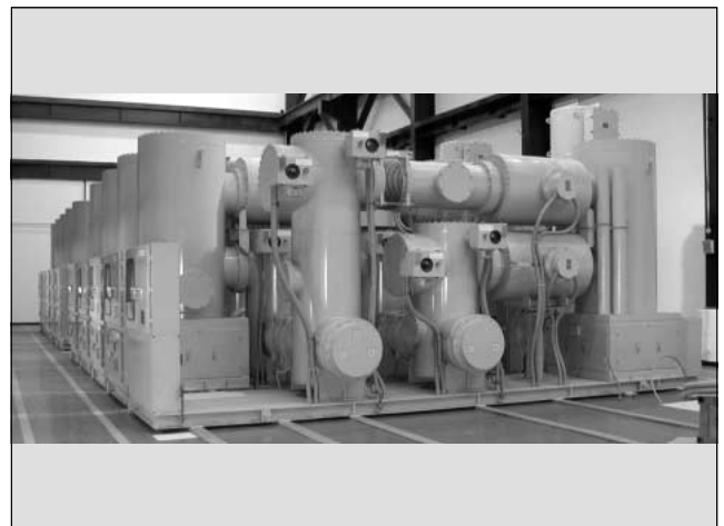
図18 161kV 50kA GIS
