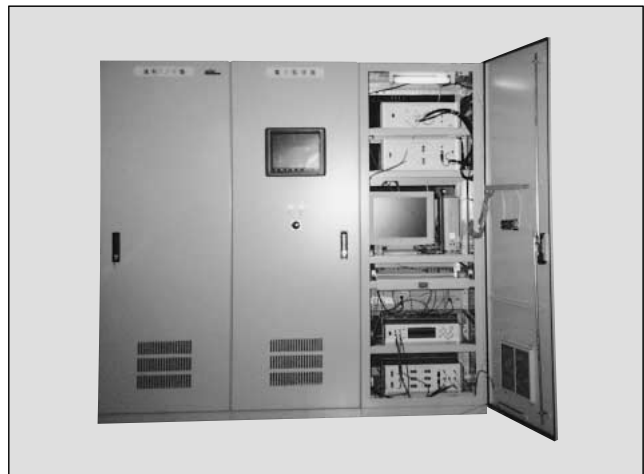
図 26 電力監視盤・検測装置盤
