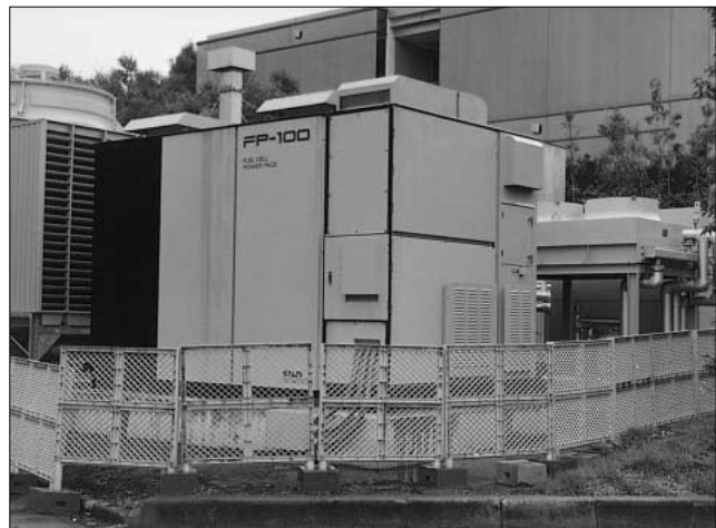
図2 100 kW 燃料電池発電装置（大学設置）
