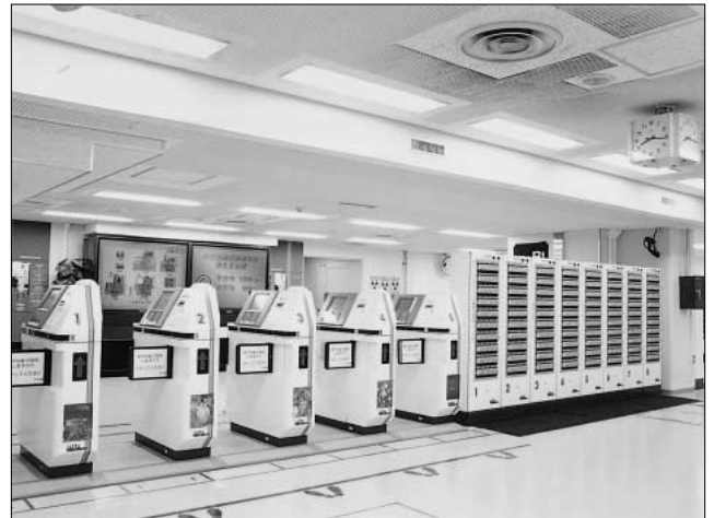
図28 入退域管理装置の設置状況
