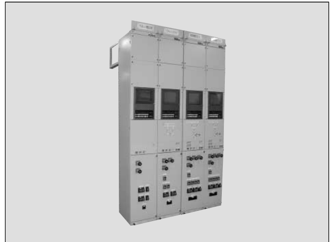
図22 回線単位制御盤(DAC)
