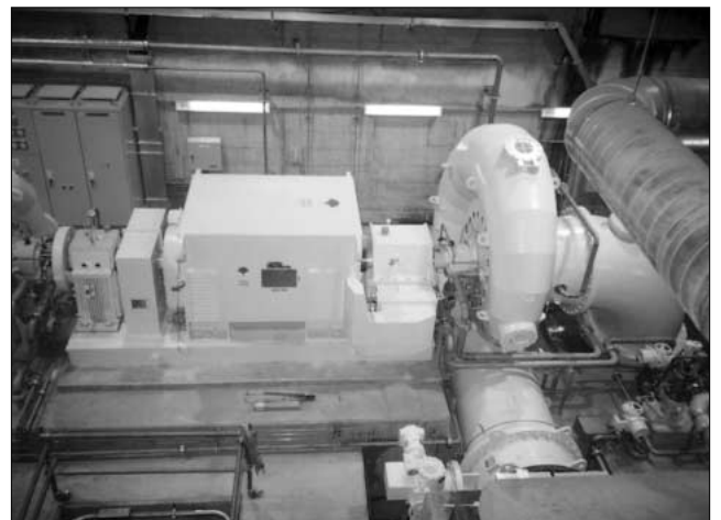
図 12 有水試験中の水車・発電機設備
