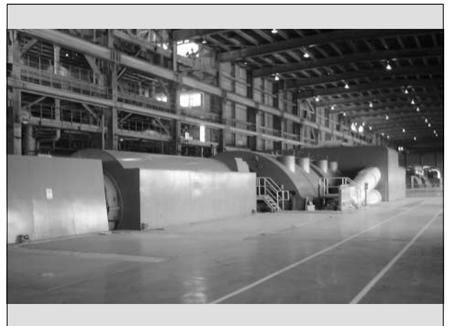
図5 600MWタービン・発電機
