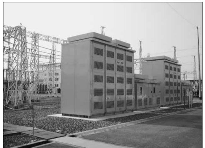
図24 中部電力(株)向け500kW×2NAS電池用交直変換装置
