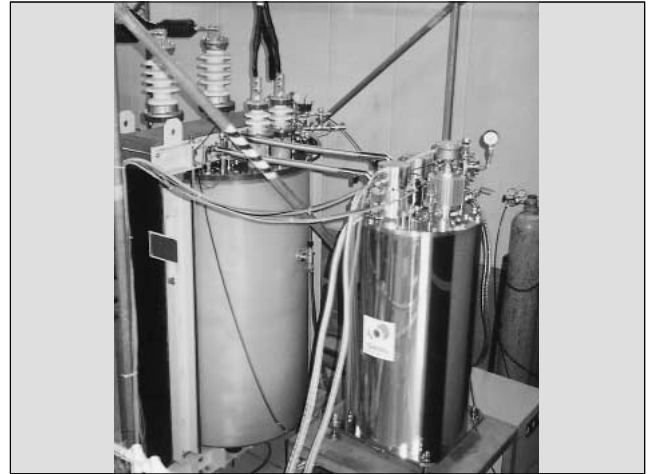
図16 高温超電導変圧器の電力系統連系運転
