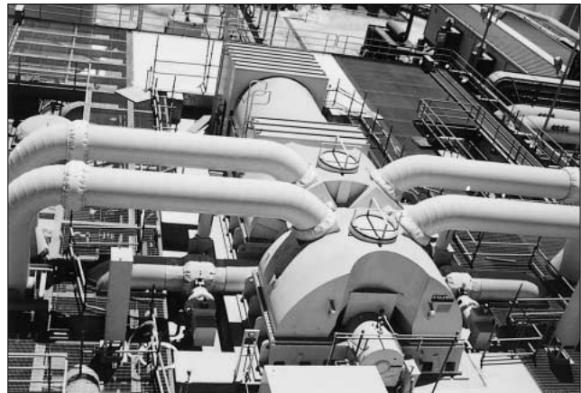
図8 地熱コンプレックス用発電設備
