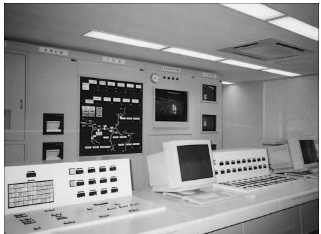
図 21 ダム自動制御装置
