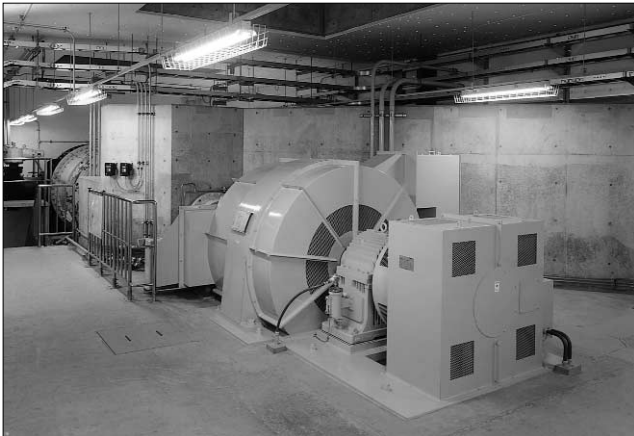
図2 東村山浄水場向け水力発電設備の外観
