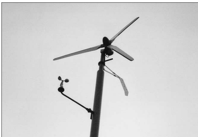
図7 東村山浄水場向け風力発電設備の外観
