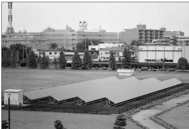
図6 東村山浄水場向け太陽光発電設備の外観
