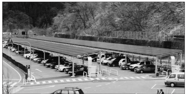
図1 陸上基地局設置太陽光発電設備
