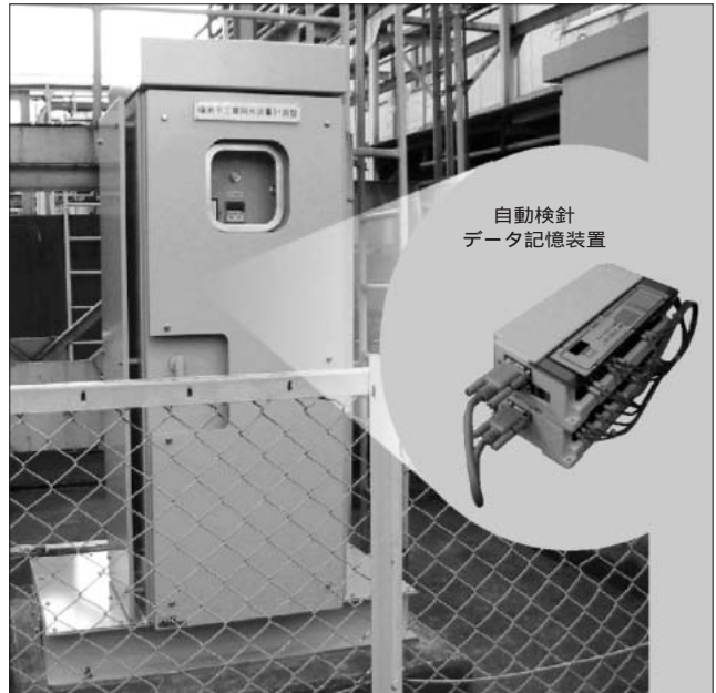
図 3 流量計測盤とデータ記憶装置の外観
