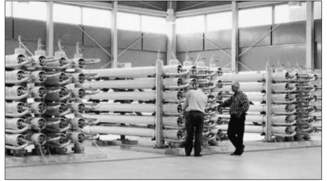
図3 膜ろ過ユニットの外観
