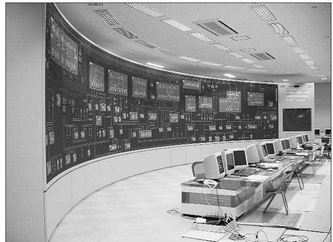
図 17 新潟技術センター制御所の制御室
