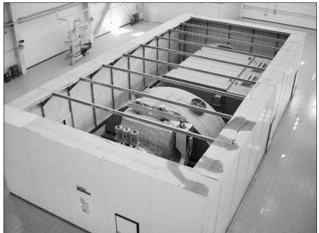
図6 タービン発電機設備の全景
