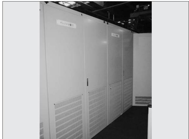
図 4 大容量周波数変換装置
