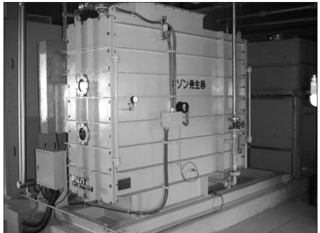
図5 下水処理水用オゾン発生器
