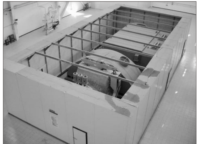
図2 162 MW タービン・発電機設備（中国浙江省）
