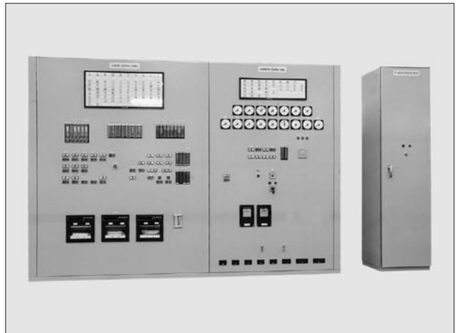
図6 蒸気タービン・発電機監視盤
