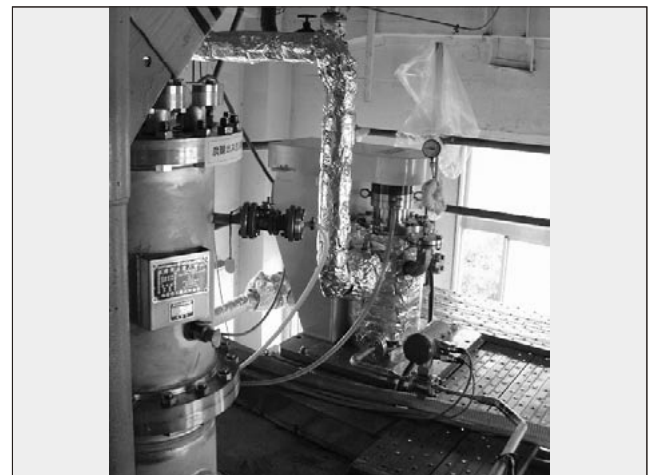
図8 アルコール廃液処理装置
