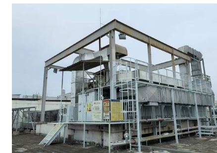
VOC回収装置
