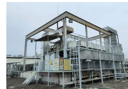
VOC回収装置
