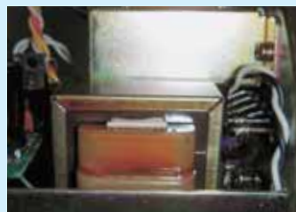
長期使用で内部の電子部品劣化
