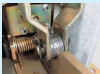
グリスアップが長期間されていないため、機構部不動作
