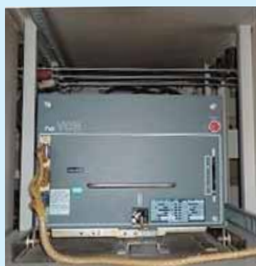
既設品 VCB 1982 年製 HA12X-M1F1-NA
