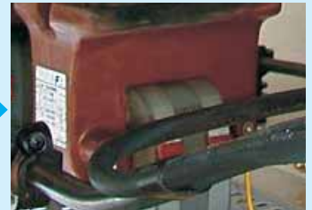
クラックが進展し部分放電、地絡事故発生
