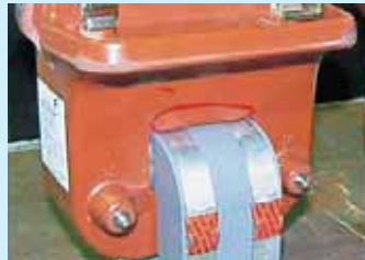
長期使用によるエポキシ樹脂の劣化、クラック発生
