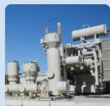
変電 システム
