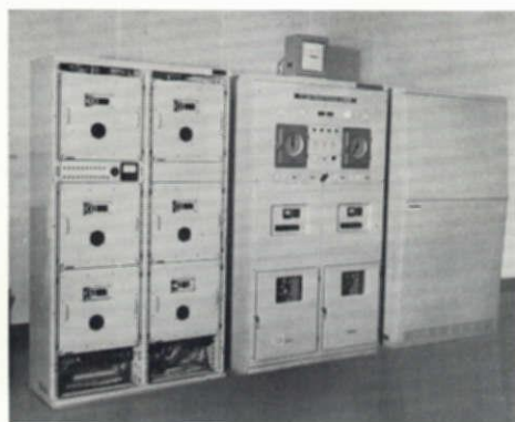
制御用マキシマムデマンドメータ（磁気ドラム式）
