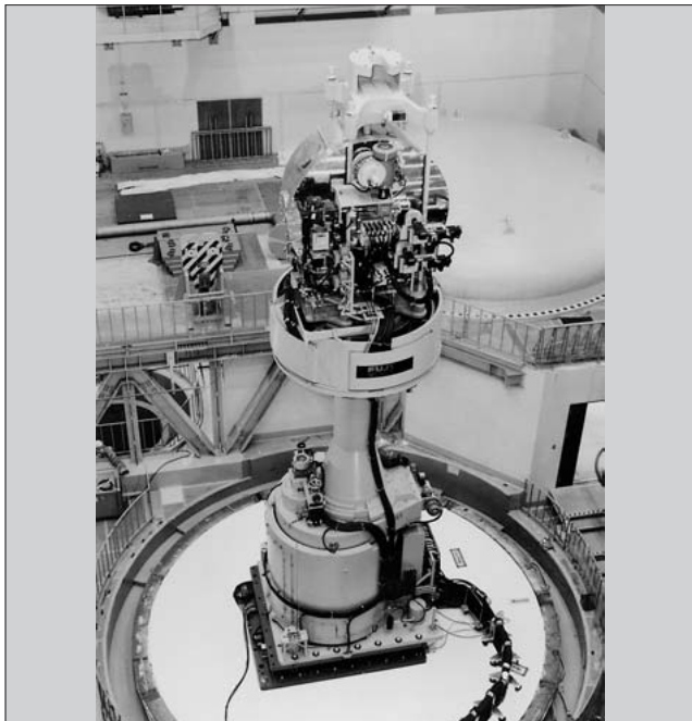
図1 燃料交換機的全景
