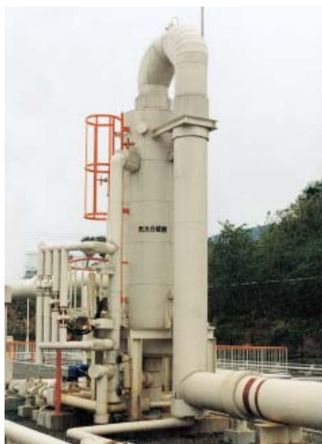
気水分離器外観
