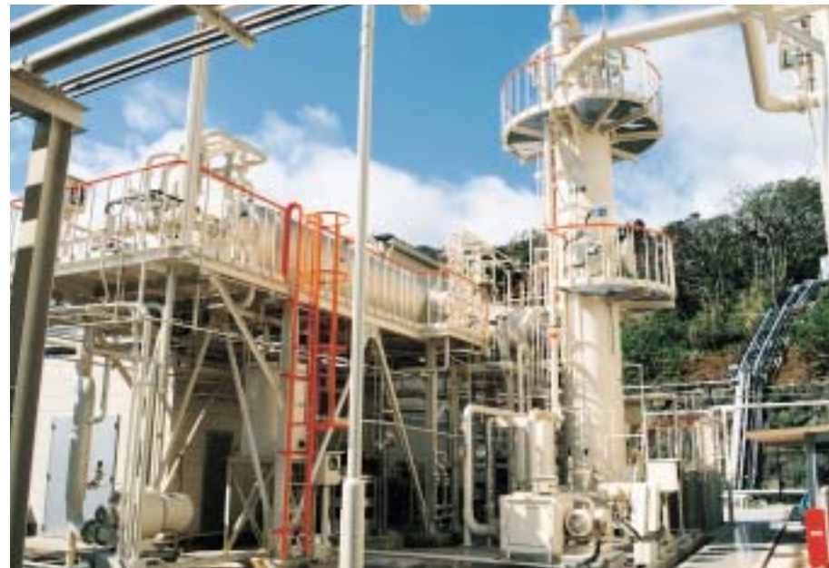
硫化水素除去設備外観
