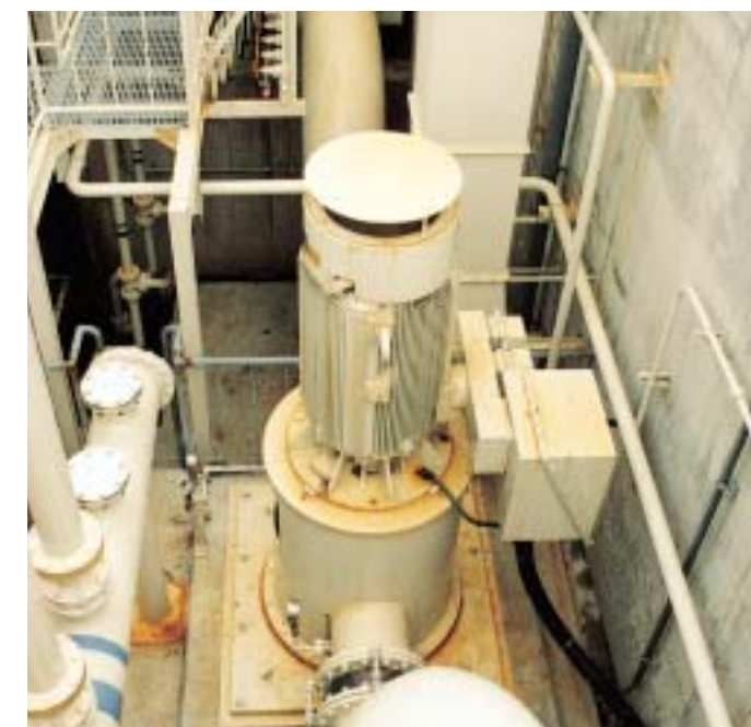
温水ポンプ外観
