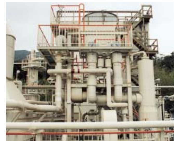
不凝縮ガス抽出設備全景
