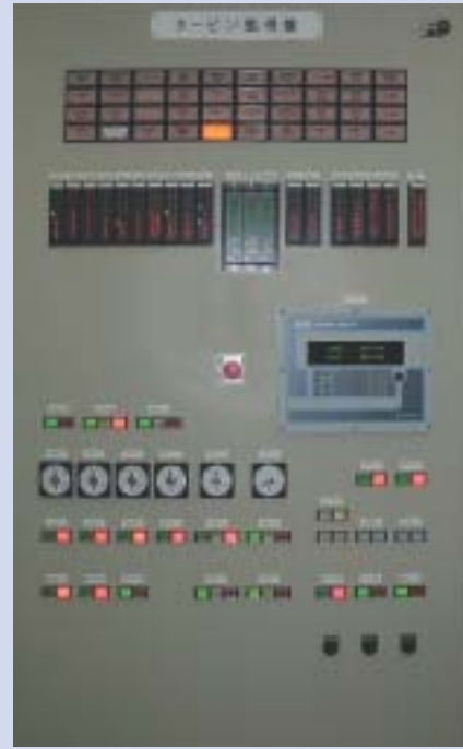
タービン監視盤外観
