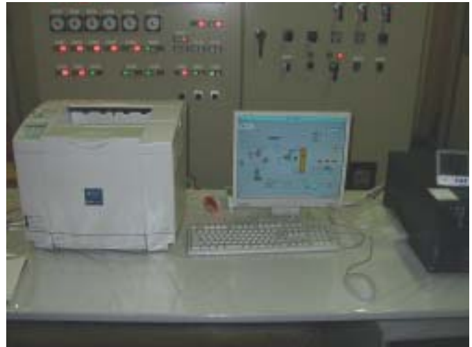
監視装置外観
