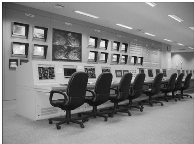
図4 中防灰溶融施設の中央制御室
