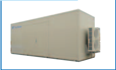
PCSを収納するコンテナの外觀
