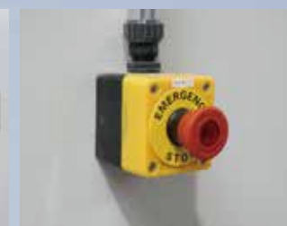
非常停止ボタン
