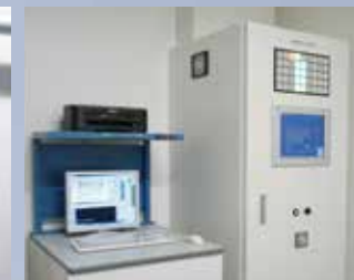
中央監視装置
