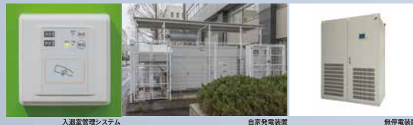
入退室管理システム
