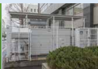
自家発電装置
