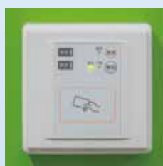
入退室管理システム
