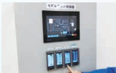
「計測制御機器基礎」 制御盤操作中
