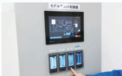
「計測制御機器基礎」制御盤操作中
