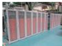
蓄電池システム
