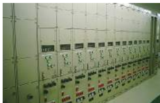
保護制御装置
