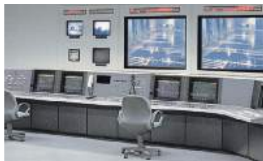
プラント監視制御システム
