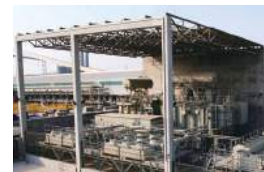
大容量整流設備
