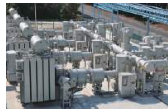
変電システム
