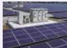
太陽光発電システム
