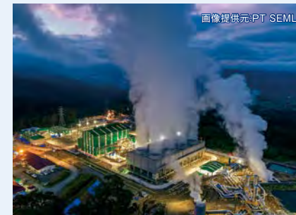
地熱発電設備
