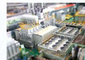
■大容量変圧整流装置
